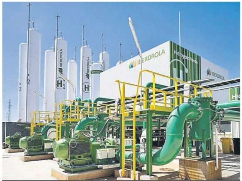
Planta de hidrógeno verde de Iberdrola.
